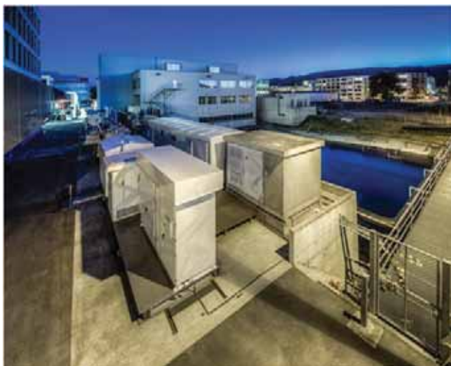
Abbildung 34 – Zurich 1MW Batteriesystem in Dietikon ZH (Quelle: Michael Koller, EKZ).
