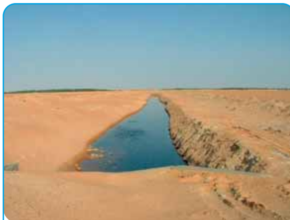
Le réseau de drainage actuel ne suffit pas pour évacuer toute l'eau d'irrigation des palmeraies. De plus une grande quantité d'eau provient des fuites du réseau d'eau potable.
